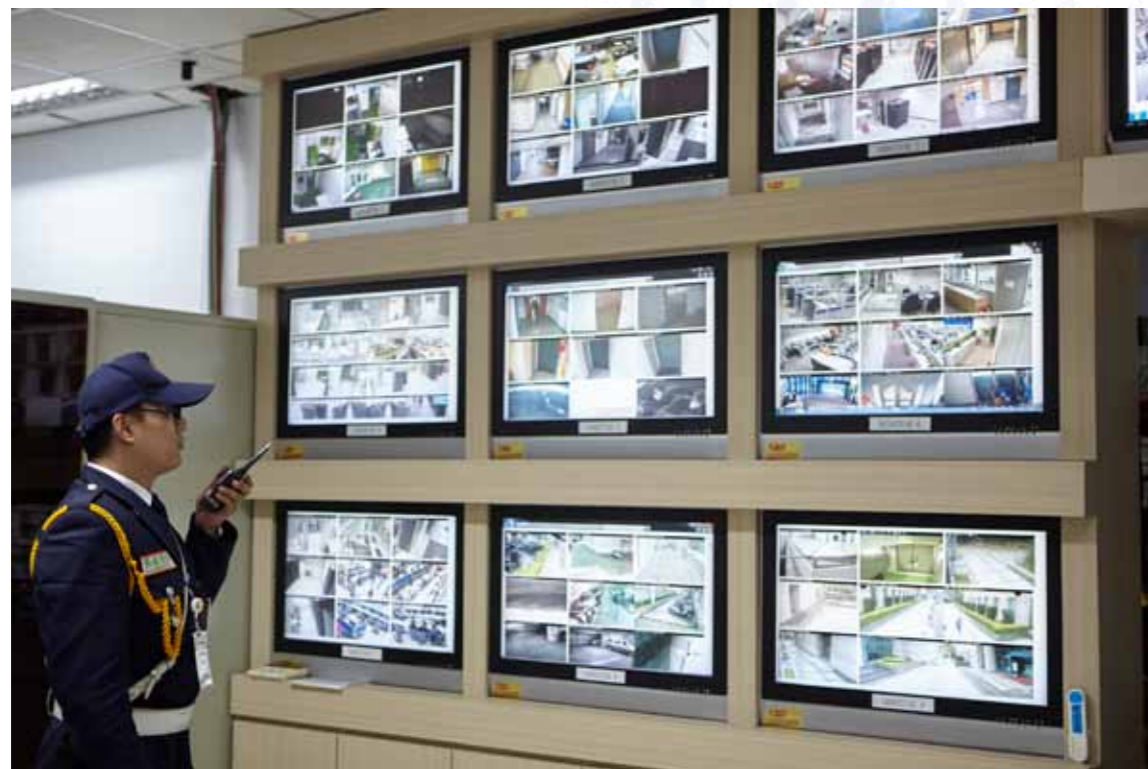
本大樓實體安全監控系統
